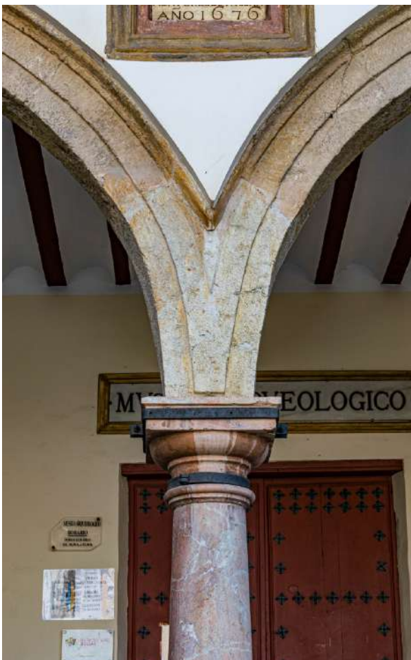
Figura 22. Casa del Concejo. Detalle de la columna central: unión del capitel con el fuste mediante lámina de plomo.
