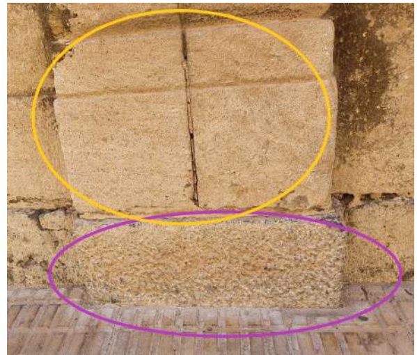
Figura 23. Detalle de la fachada del Casino. Morado: calizas triásicas. Amarillo: calcarenitas.
