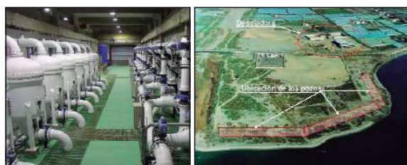
Ilustración 3-4: Planta desaladora de Carboneras (Almería). Pretratamiento y Ubicación (Fuente: Acuamed)
