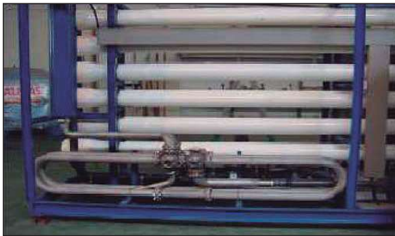
Ilustración 11: Cámara de intercambio de presión (Fuente: RO Kinetics).
