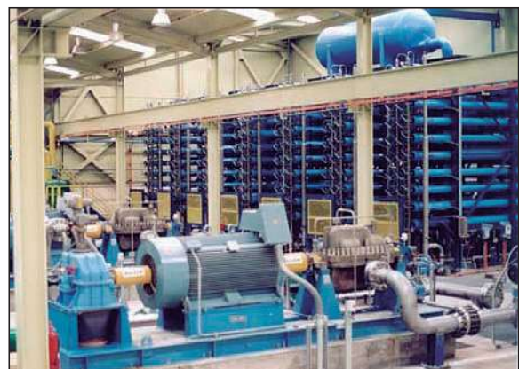
Ilustración 7: Módulos de O.I en Desaladora de Carboneras, Almería. (Fuente: Acuamed).
